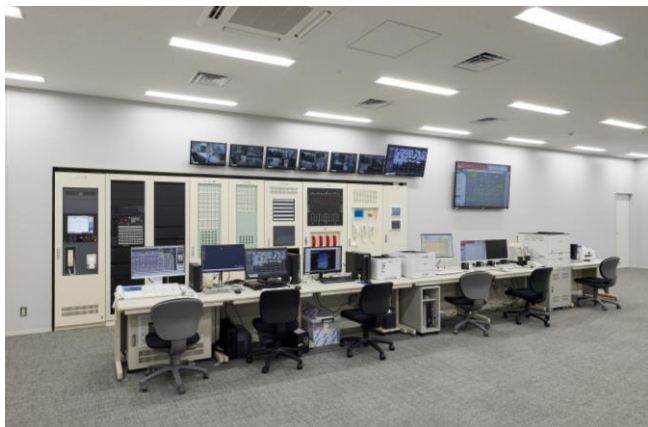
▲防災センター
